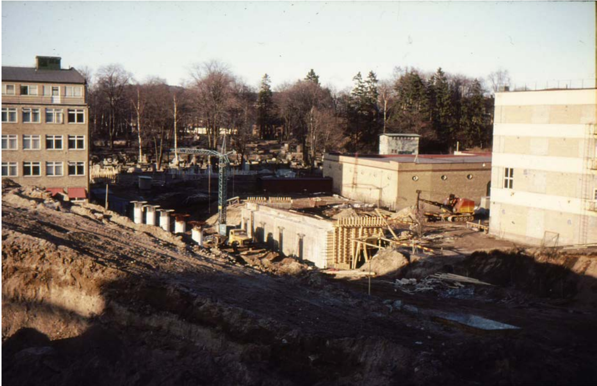
Nu har man schaktat ur en massa och börjat gjuta för motorvägen.
